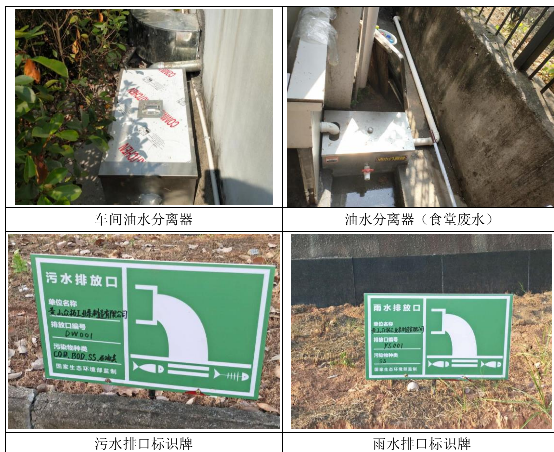
图 3-2 项目废水治理设施建设情况
