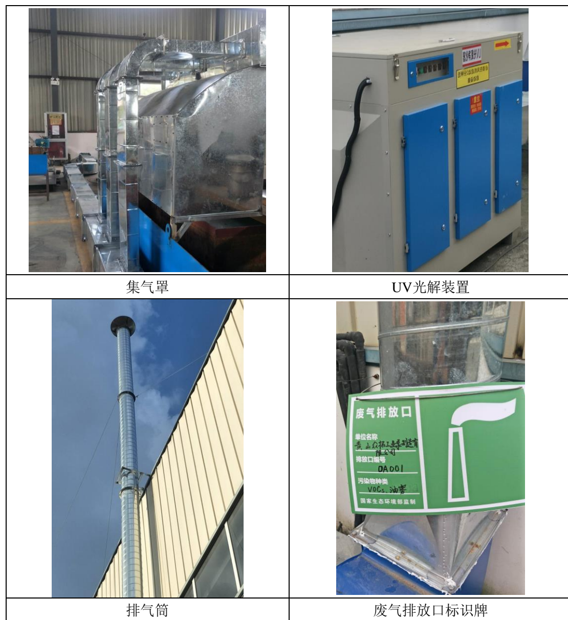
图 3-1 项目废气治理设施建设情况
